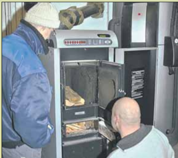
Inbetriebnahme eines Festbrennstoffkessels.
