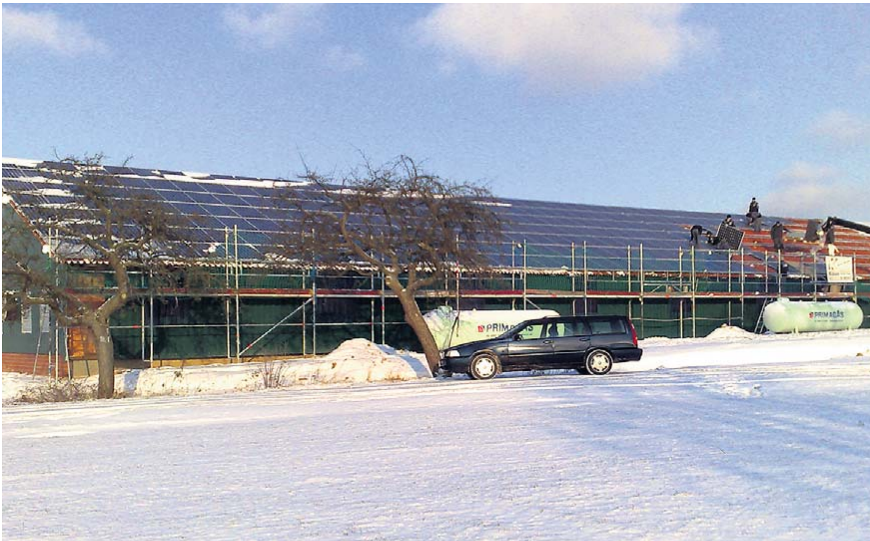
Dieser Hähnchenmaststall in Brunnighausen ist mit einer der größten Photovoltaik-Aufdachanlagen der Region ausgestattet.
