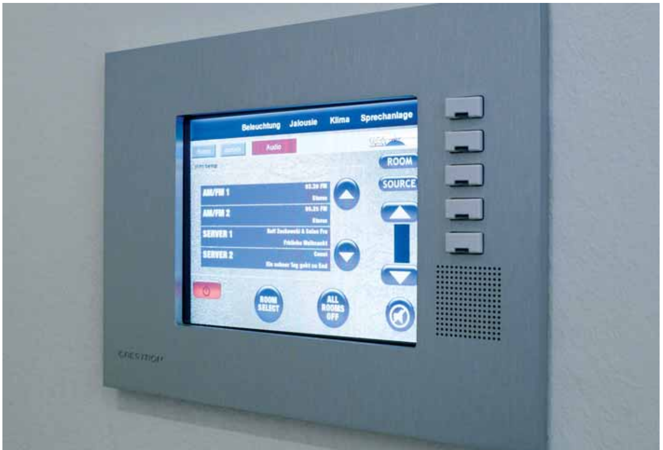
Eins der kleineren Crestron-Panels im Obergeschoss mit angepasster Visualisierung der Hauselektrik
