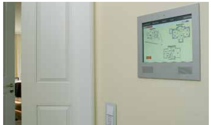
Nach Etagen und Funktionen sortiert, gibt die Oberfläche auch gelegentlichen Benutzern keinerlei Rätsel auf, lässt die Bewohner aber auch nicht über den Zustand des Hauses im Unklaren
