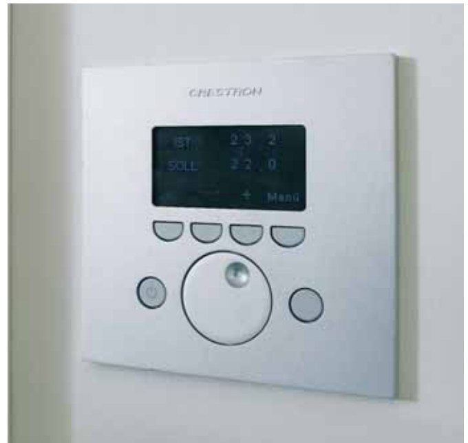
Die Bedieneinheiten des Adagio-Systems steuern nicht nur den guten Ton, sondern auch Teile der Hauselektrik
