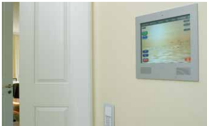
Im Erdgeschoss bietet ein großes Crestron-Panel Zugriff auf alle Funktionen des Hauses
